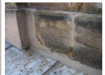
Steine aus Beton mit imitierter, defekter "Naturstein"-Schicht.
